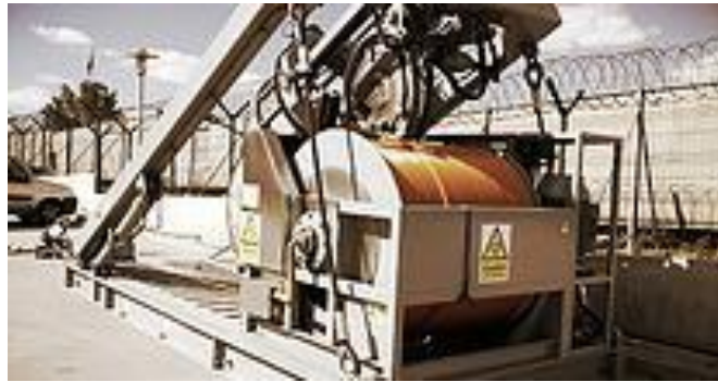
Resim 4. Umbilikal kablo makarası.
